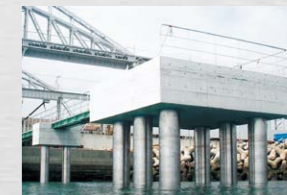
チタンカバー・ペトロラタム被覆工法(TP工法) 鋼管杭への施工例
