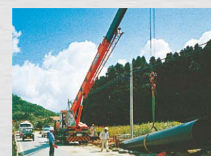
水道管 (ポリウレタン被覆)
