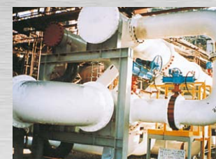
冷却水配管 (ナイロンコーティング)
