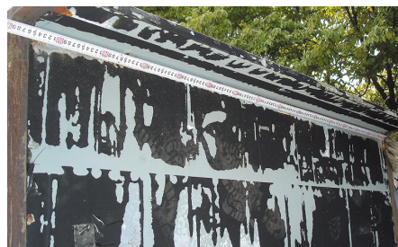
12年経過後の試験体状況 (チタン箔シート剥離後)
