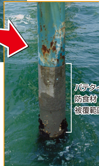
20年経過時点の状況
